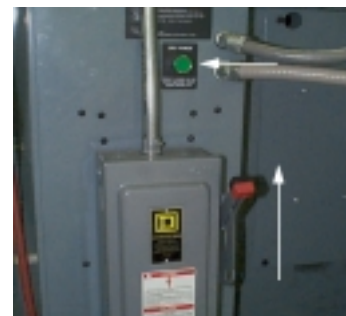
Figura S: 1-5 Caja eléctrica principal y botón de conexión verde.
